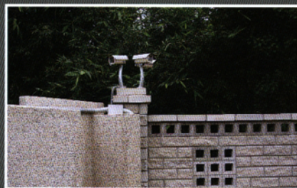
社區周邊紅外線遠端監視錄影系統
